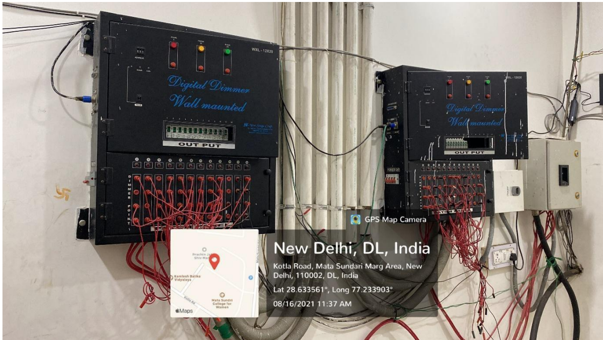
Digital Dimmer (Auditorium)
